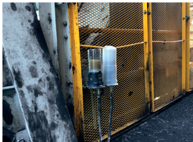
Sector: Indústrias de brita e cascalho Aplicação: Correia transportadora
