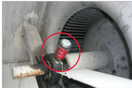
Industrie: centrales électriques
