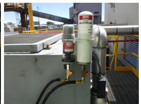
Fin fan lubrication
