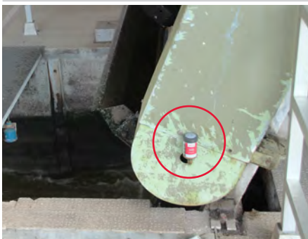
Lubricación de rodamientos en el cribado grueso
