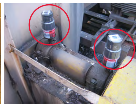
Lubricación de los cojinetes del eje del ventilador
