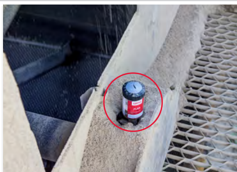
Lubricación del cojinete de soporte en los cribados de arena y de gravilla
