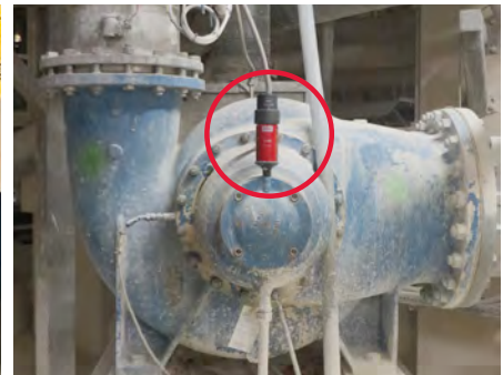
Lubricación del cojinete de una bomba
