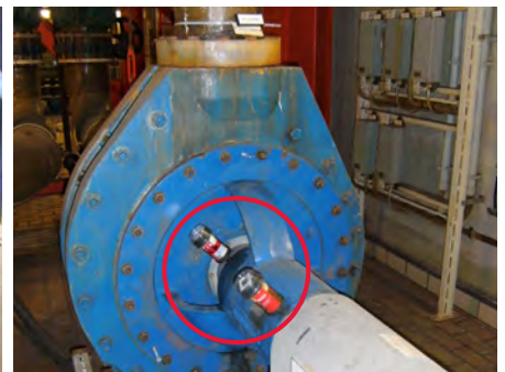
Lubricación del árbol de transmisión de una bomba
