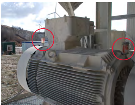
Lubricación de motor en una criba vibratoria
