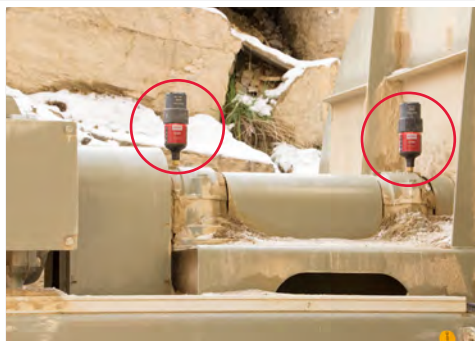
Lubricación del cojinete de soporte de un eje del ventilador
