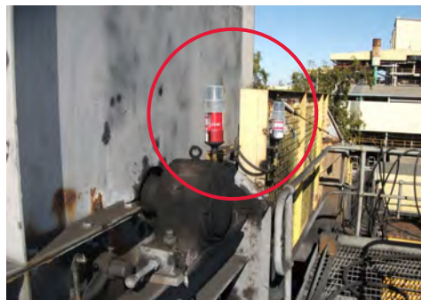
Lubricación del cojinete de soporte de una cinta transportadora
