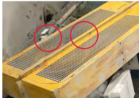
Lubricación del cojinete de soporte de un ventilador
